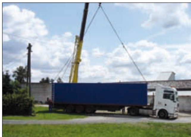
Bild 3: Aufstellung des Gascontainers der Pilotanlage
